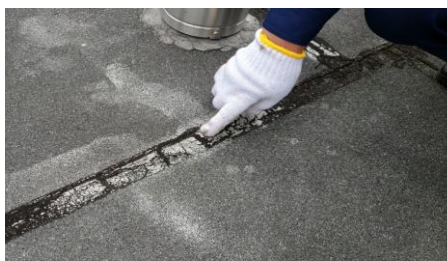
防水ジョイント劣化
