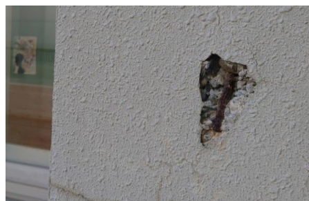
凍害による爆裂
