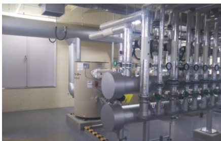
【余裕のある機械室（岩内町役場）】
