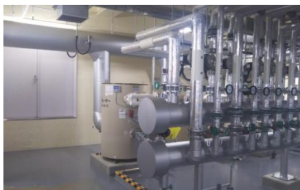
【余裕のある機械室（岩内町役場）】
