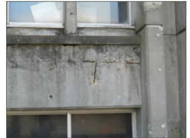
【外壁の鉄筋露出】
