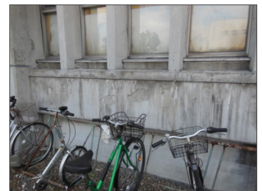
【外壁の仕上剥離】
