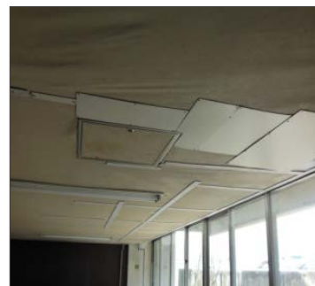
【室内天井の剥がれ】
