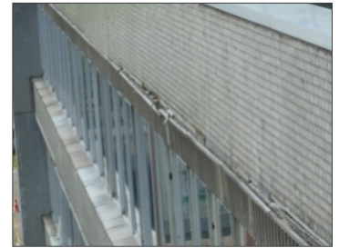
【外壁のタイル剥離】
