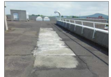
【屋上の仕上剥離】
